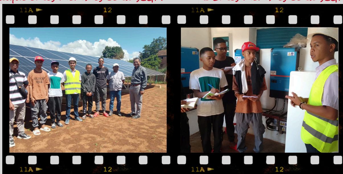
MAHAIZA : Chantier école avec les élèves du Lycée KAMAFA et Hermann (ANKA)
